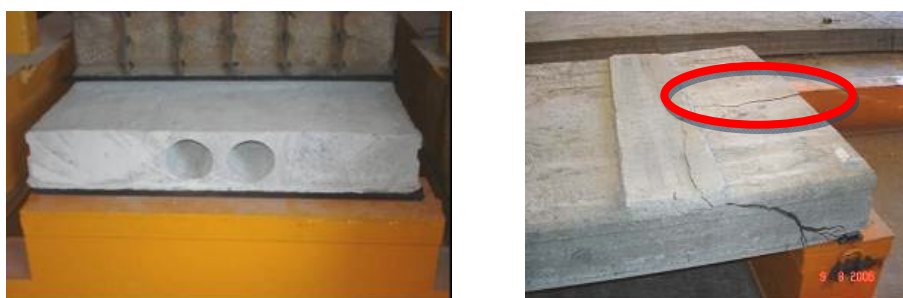
Figura 13 – Configuração de fissuração das lajes com quatro alvéolos preenchidos.
