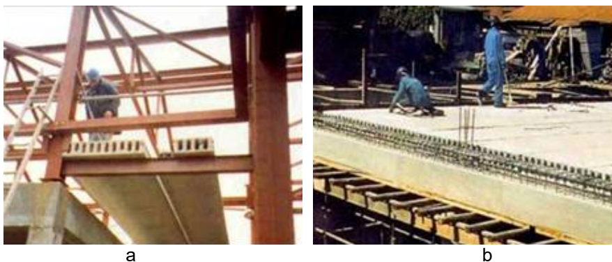
Figura 1 – Aplicação de unidades alveolares sobre estrutura metálica (UK); b) Aplicação de unidades alveolares sobre concreto moldado no local (África do Sul, 2001). Fonte: FERREIRA (2007).
