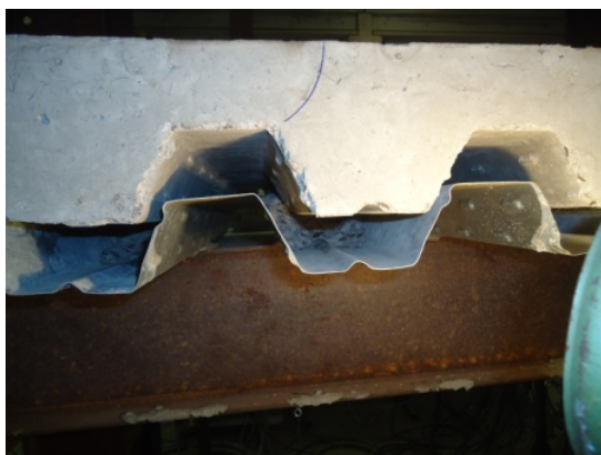
(a) Desprendimento da laje
