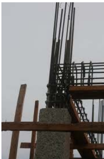
Figura 1 – Congestionamento de armaduras na ligação viga-pilar 3 .
