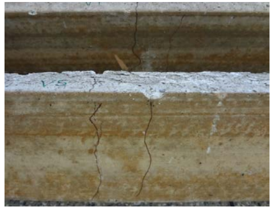
b) Fissuração na vigota V5-TR 10645 e 2 fios de protensão de 5mm cada.
