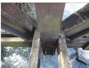
(a) Montante deteriorado
