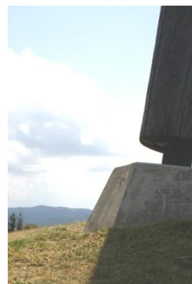
Detalhe do bloco de fundação com fixação da placa de base da coluna
