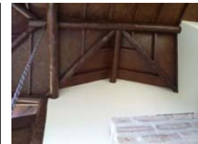
Estrutura da cobertura do hall de entrada principal. Forro com chapas de OSB.
