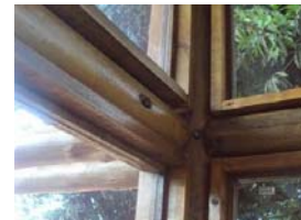
Sistema de instalação dos vidros da fachada com sarrafos fixados nas peças roliças.
