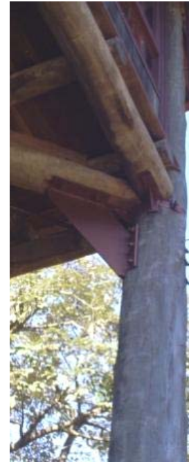
Detalhe das conexões metálicas tipo consoles, parafusadas com barras de aço rosqueadas passantes, arruelas e porcas, que unem as vigas da estrutura do piso à coluna de canto.
