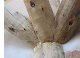
Detalhe das conexões das escoras inclinadas (Mãos Francesas tridimensionais), fixadas c/ barras rosqueadas passantes, arruelas e porcas.
