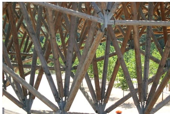
Detalhe da estrutura da treliça espacial com peças roliças de pequeno diâmetro, e das conexões metálicas especiais.
