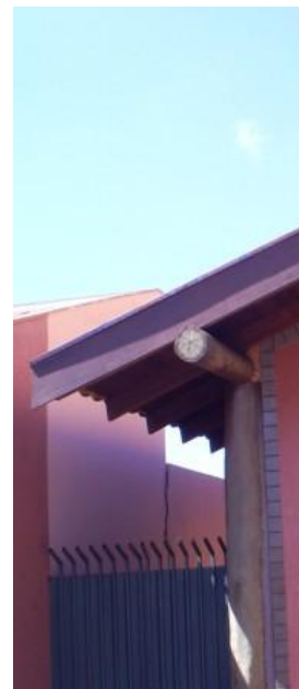
Conexão viga-coluna, viga apoiada no topo da coluna e interligada com pino metálico de vergalhão de aço CA50.
