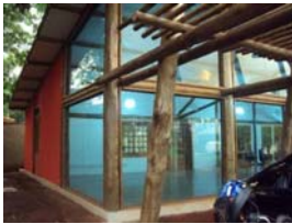
Vigas com seção composta dupla, fixadas nas colunas, com barras de aço rosqueadas passantes, arruelas e porcas.
